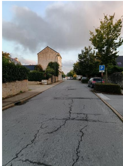
Signalétique tardive et peu détaillé du parking rue Bouruet Aubertot
