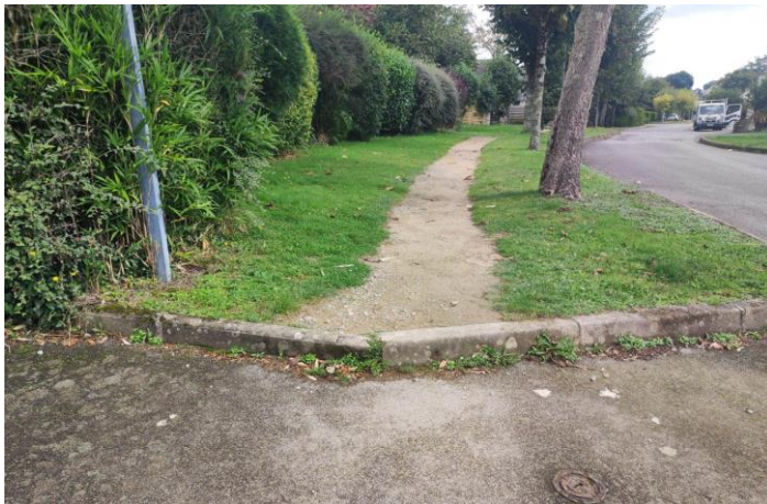
Rue Men Gwenn : absence d'abaissé de trottoir
