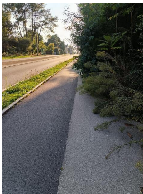
Végétation et problématique d'entretien sur la RD 101
